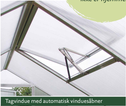
Tagvindue med automatisk vinduesåbner
